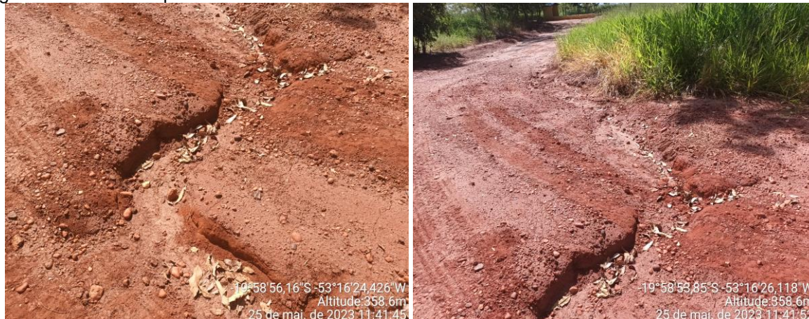
Figura 4. Ponto 2: Erosão em sulcos no acesso interno da área 1 da PCH Verde 4, no município de Água Clara/MS. Campanha de maio de 2023.
