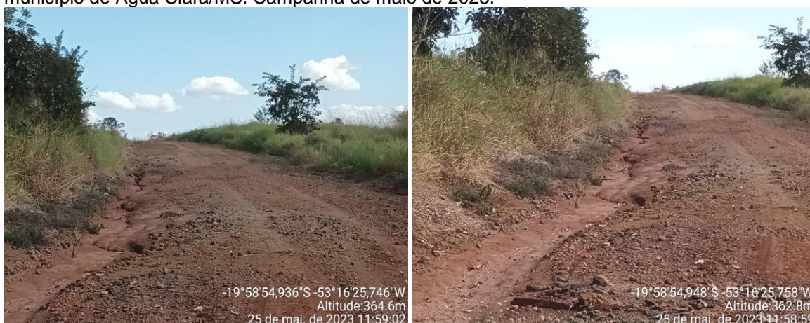
Figura 5. Ponto 3: Erosão em sulcos na lateral da via de acesso, área 2 da PCH Verde 4, no município de Água Clara/MS. Campanha de maio de 2023.
