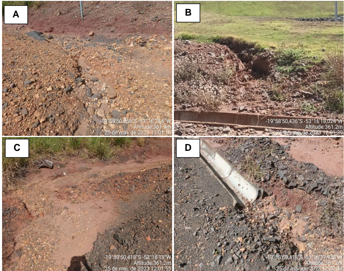
Figura 6. Ponto 4: Erosão em sulcos na lateral da via principal de acesso (A - C), e canaleta não finalizada (D), na área 2 da PCH Verde 4, no município de Água Clara/MS. Campanha de maio de 2023.
